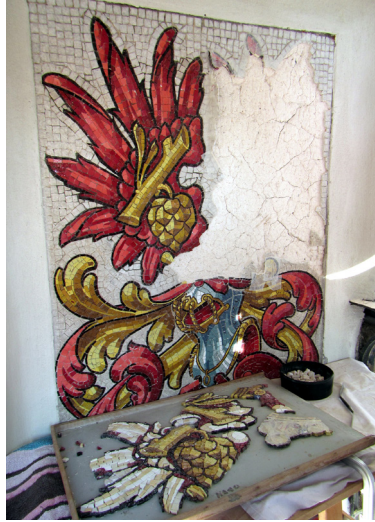
Hall, Rathaus: 1897, Mosaikwappen, 150 x 80 cm. (Neuhauser'sche Mosaikanstalt, Entwurf: R. Schwarzenberger) Geöffnete Hohlstelle: lose Bereiche werden abgenommen und in frischem Mörtel gebettet. Restaurierung: 2014
